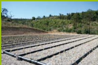
La nouvelle station d'épuration d'Esparron-de-Verdon
