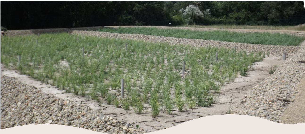
Station d'épuration de Bauduen ©PNR Verdon
